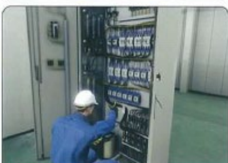
⑧ 盤内配線作業中の感電 監修:富士電機株式会社
