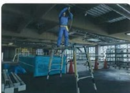
⑥ 開口部廻りの危険体験 監修:清水建設、戸田建設、三機工業
